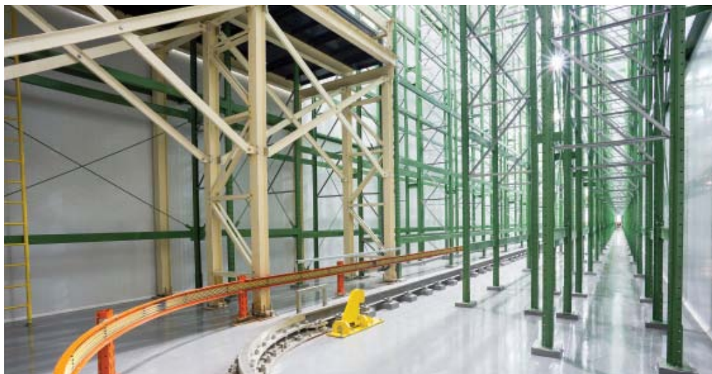
Câmara fria com transelevador - RIOgaleão
