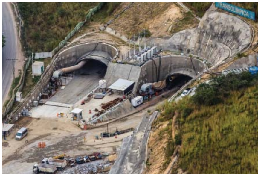
As obras do BRT Transolímpica incluem dois túneis na serra do Engenho Velho
