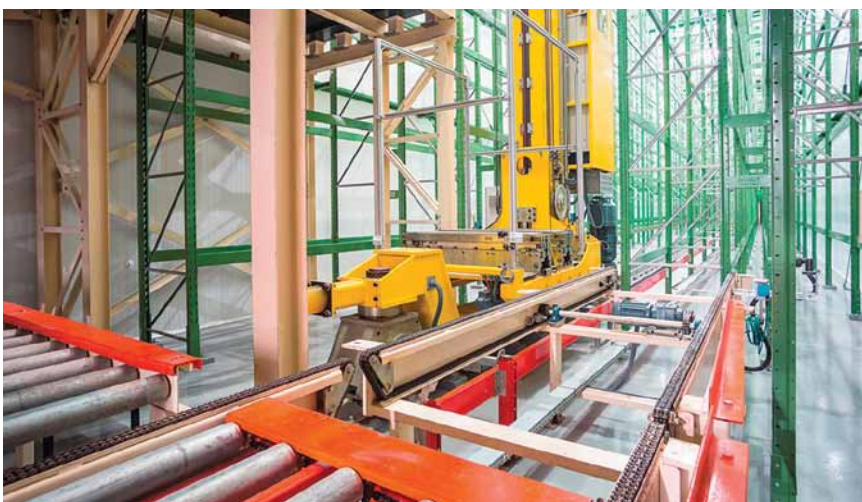
A nova câmara fria do RIOgaleão Cargo ganhou mais agilidade de operação com um transelevador para a movimentação de cargas em paletes
