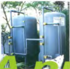
Estação de Tratamento de Água e Efluentes para Descarga ou Reuso
