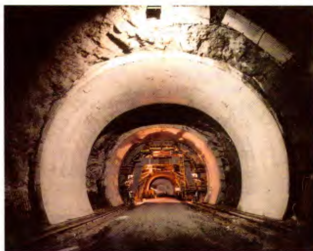
A nova pista tem apenas três túneis, que totalizam 8,23 km, 70% do trecho da serra
