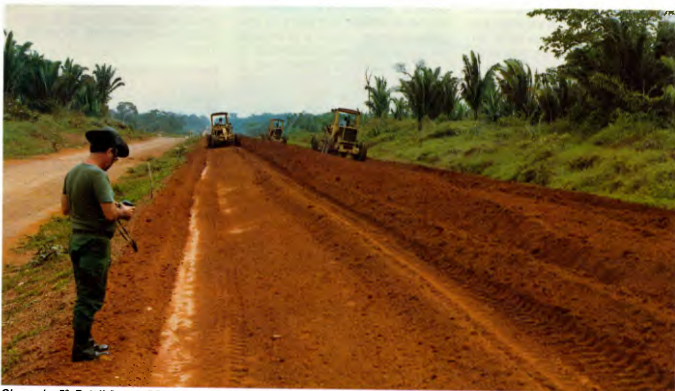
Obras do 5º Batalhão na BR-425, entre Abunã e Guajará-Mirim, em Rondônia
