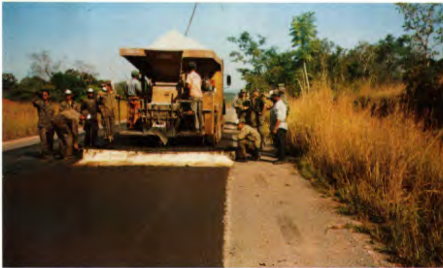
Conservação em trecho da BR-070, em Mato Grosso
