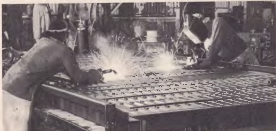
Chapas soldadas garantem impermeabilização perfeita.
