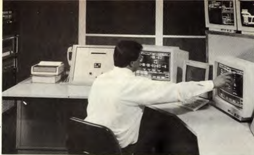
O sistema é monitorado a partir de uma central de controle
