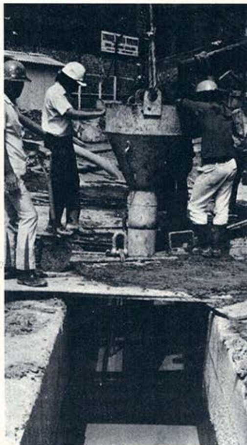
A escavação da vala e a concretagem são executadas submersas em lama bentonítica.
