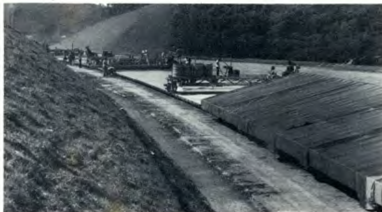
Atrás do trem de concretagem, coberturas de lona protegem a cura do concreto.
