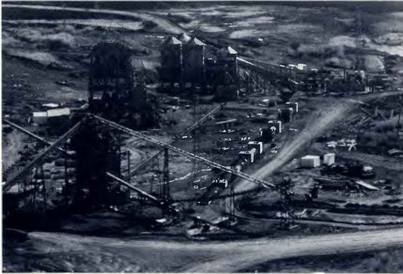
As centrais de britagem e instalações complementares já estão em testes
