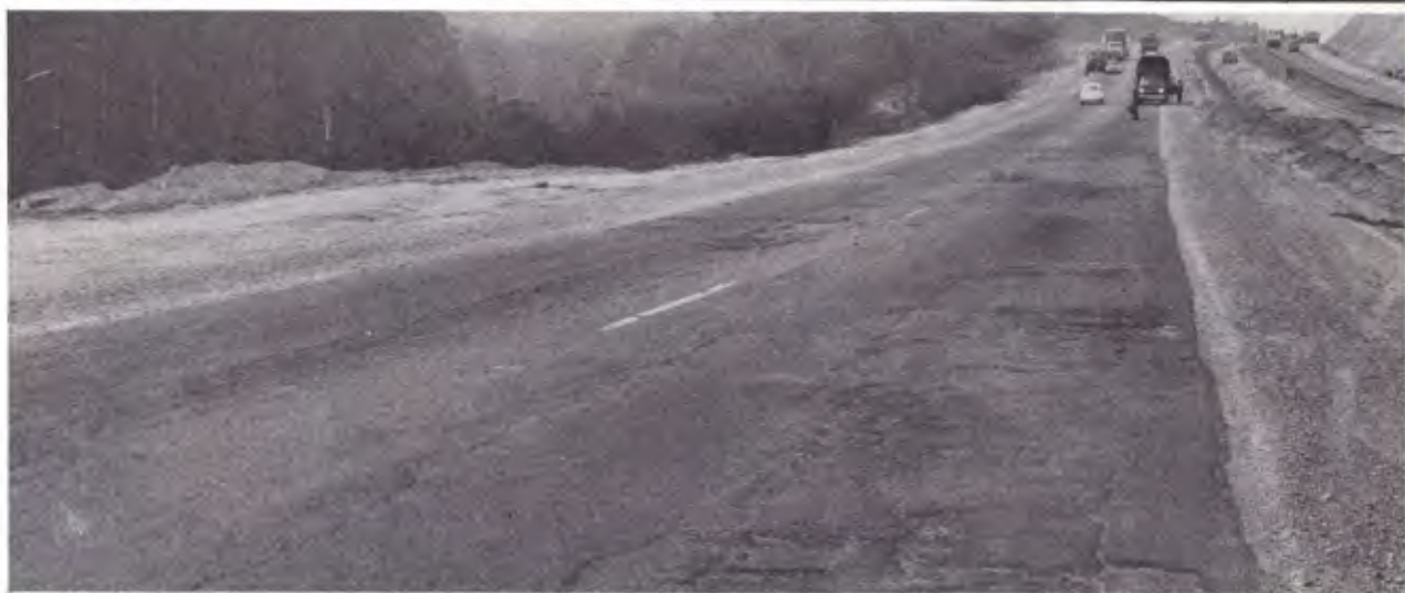
No planalto e na montanha, chuvas freqüentes causam grande erosão ao asfalto.
