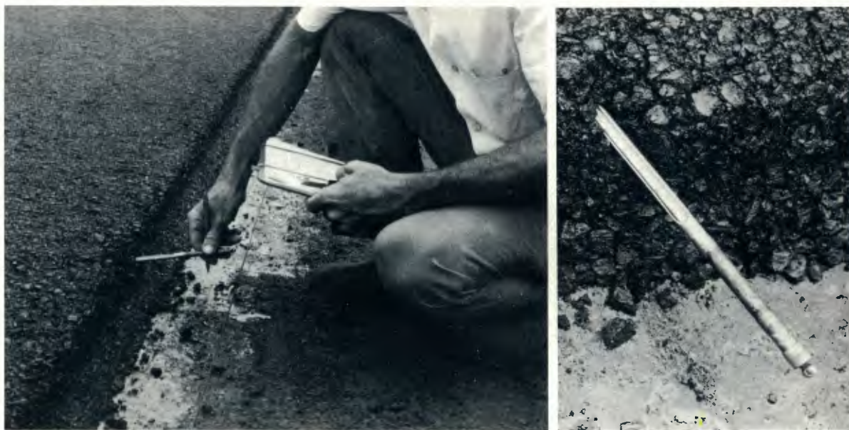
Na preventiva, os custos de conservação se reduzem a um quarto ou até um quinto do que custaria a restauração
