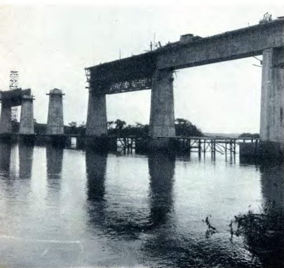
As vendas de materiais de construção ultrapassaram Cr$ 4 bilhões em 1972 e deverão atingir Cr$ 6 bilhões em 73 (ponte para via férrea-FEPASA).
