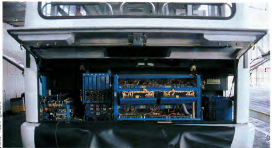
O sistema elétrico principal foi reduzido em 1.000 ligações
