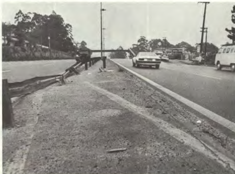
Km 12. Marcas de acidente provocado por colisão com o guard-rail
