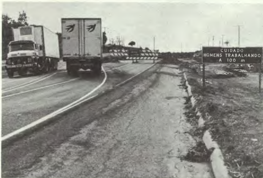
Pista bloqueada no km 620: o trevo para Presidente Venceslau estava em obras
