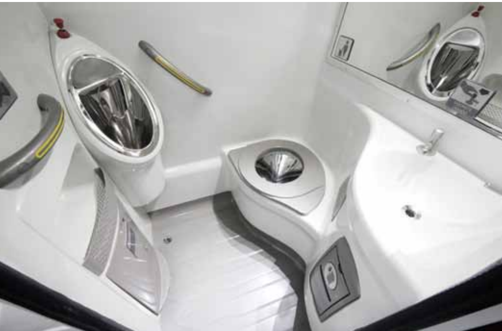
O sanitário conta com sistema de exaustão mecânica e torneiras com temporizador
