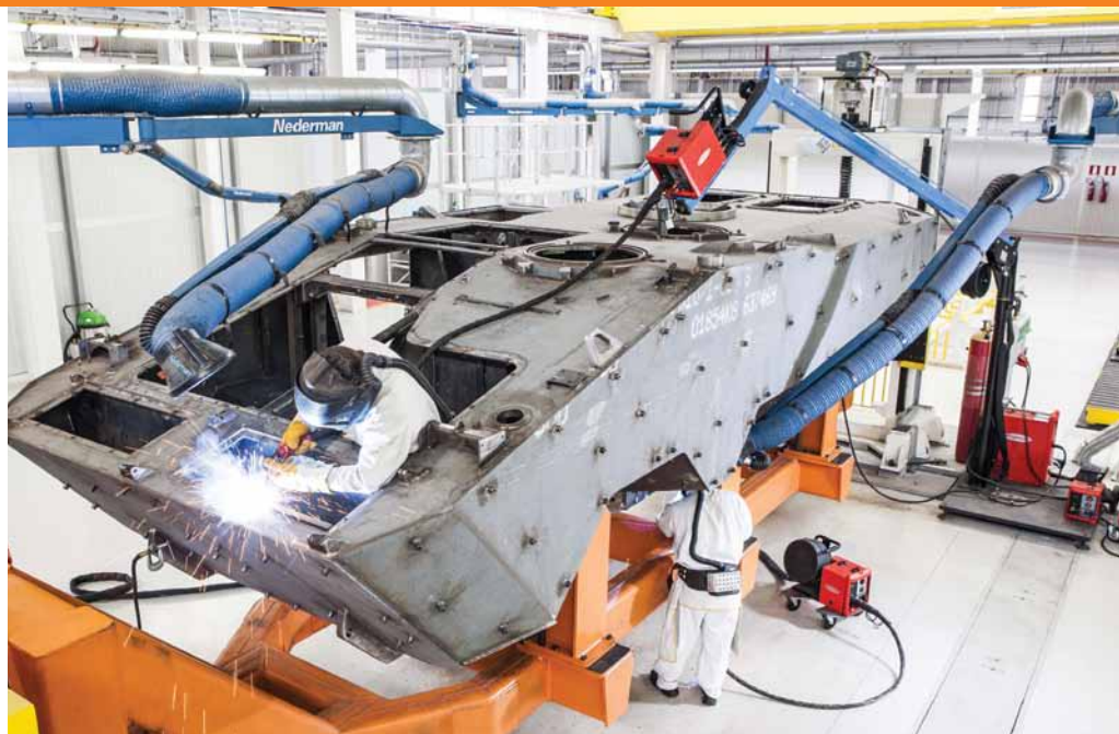
A soldagem precisa ser feita com o veículo em plano para ser perfeita em todos os pontos
