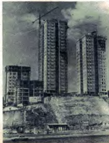
Quando o guindaste fixo sobe com a construção, ele é estaiado na estrutura da própria obra, para maior segurança. A Tecnotransportes, sediada no Rio, produz dez modelos sob licença da Pingon, francesa.
