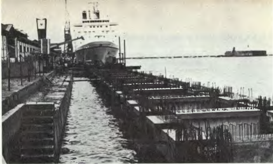
O cais paralelo, já em construção: 120 m serão entregues no mês de maio
