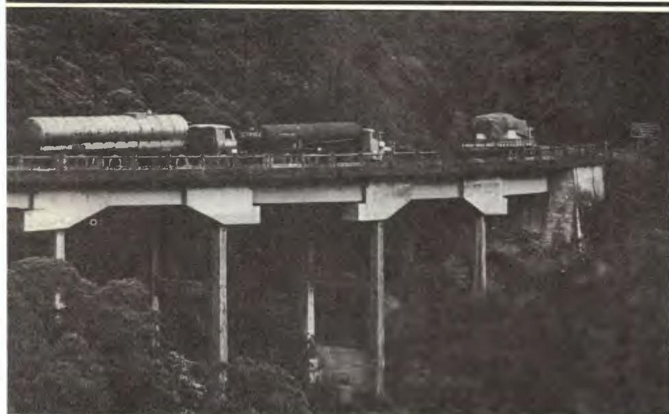
Os viadutos da Anchieta foram construídos quando não havia caminhões pesados
