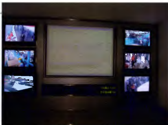
O centro de operações acompanha visualmente a situação nas plataformas e a movimentação dos veículos
