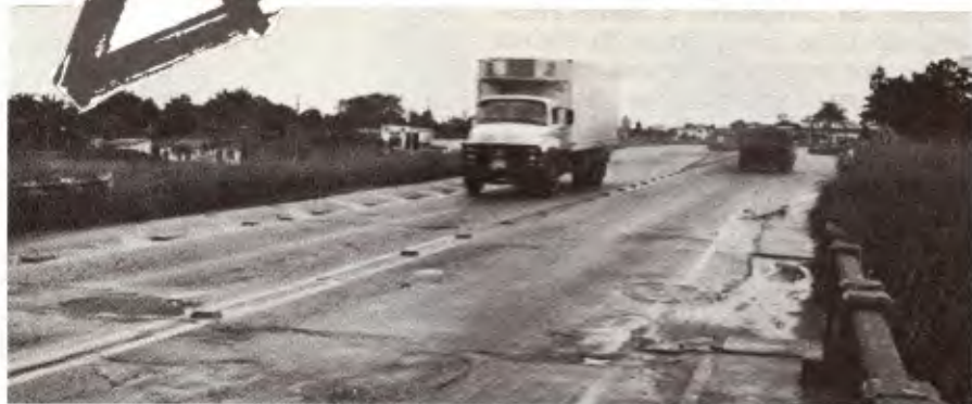
Defeitos na pista, as principais causas dos acidentes na Régis Bittencourt
