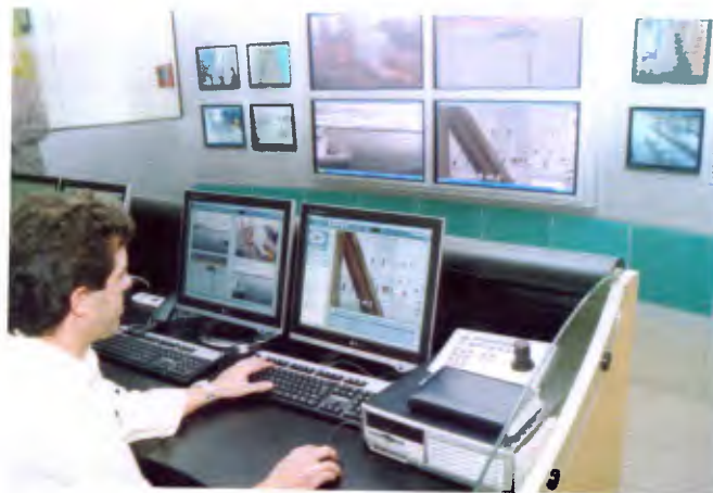
Implantação de sistemas e equipamentos de segurança no Porto de Santos contou com verba de R$ 40 milhões
