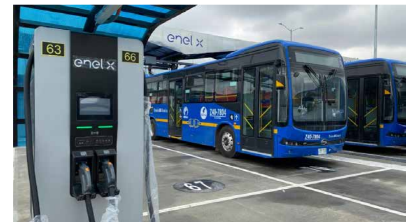
Pátio elétrico da Enel X em Bogotá, Colômbia
