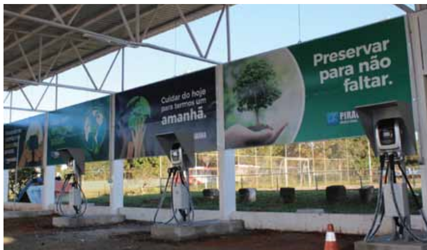
A empresa utiliza energia fotovoltaica, que é produzida a partir da radiação solar, para reabastecimento dos veículos elétricos
