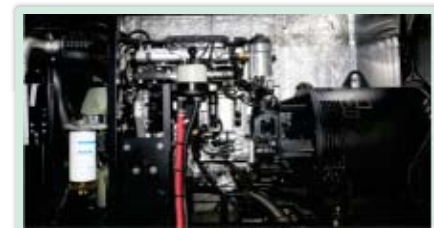
Grupo Motor-gerador (GMG)
