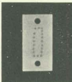
Lamina de aço corroída
