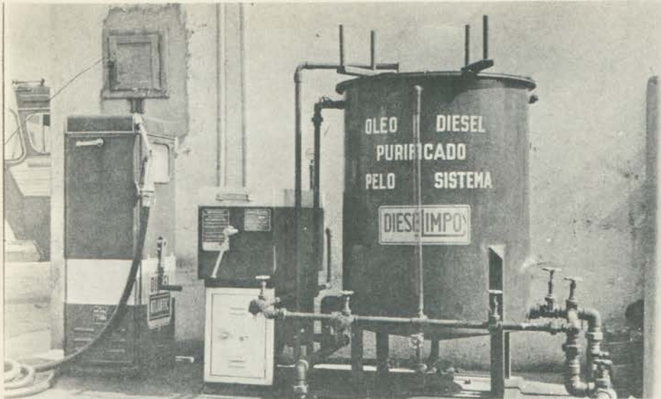
Conjunto Dieselimp, com filtro-prensa, tanque e encanamentos, junto à bomba.
