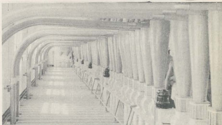
Uma bateria de ventoinhas num moinho de trigo. Cada um dos motores impulsiona nove delas. Funcionam desse modo como força auxiliar em meio à tubulação.
