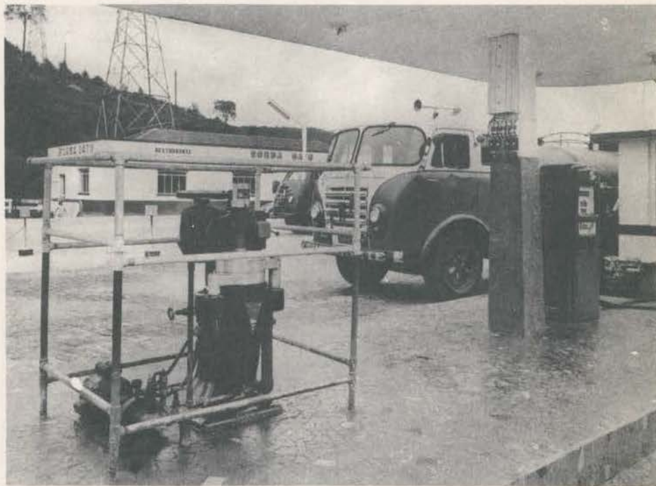
FACIL INSTALAÇÃO — Um aparelho centrifugador destinado à purificação de óleo combustível instalado num pôsto da Via Anhanguera. O depósito é subterrâneo.
