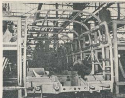
FASE — Estrutura e chassi estão sendo soldados. Serão, depois, uma só peça.
