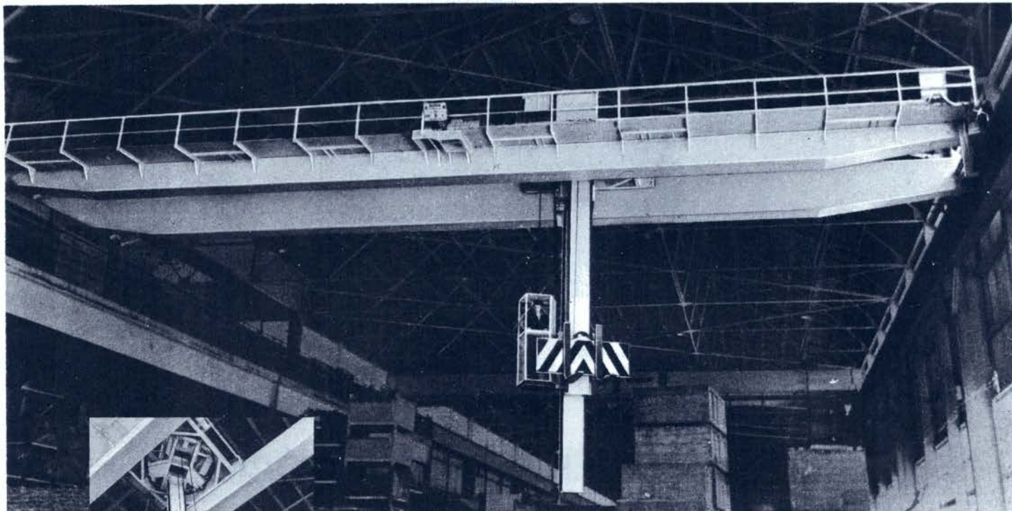
Ponte Rolante Empilhadeira MUNCK instalada numa indústria em São Paulo
