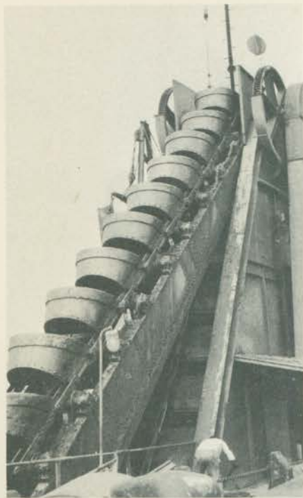
AREIA É PROBLEMA — A draga no pôrto de Santos é instrumento imprescindível. O canal de acesso à faixa do cais enche-se constantemente de areia tornando necessário um trabalho de dragagem a fim de desentupí-lo.
