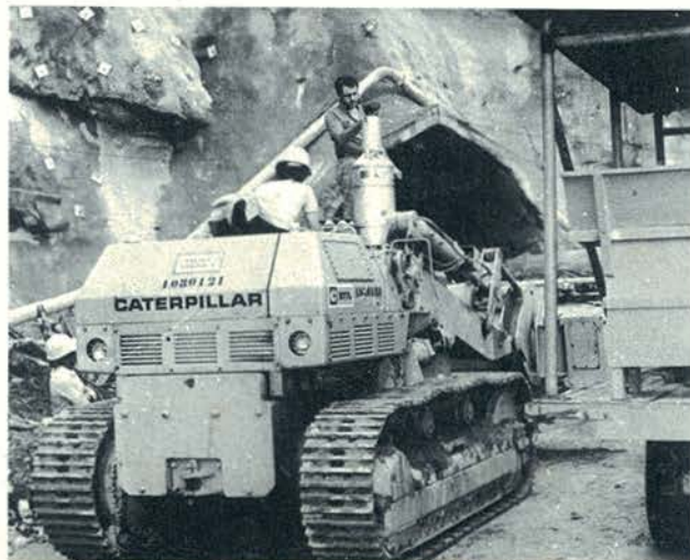
Na obra da Imigrantes, o oxícatalisador reduziu a concentração de gás carbônico nos túneis.
